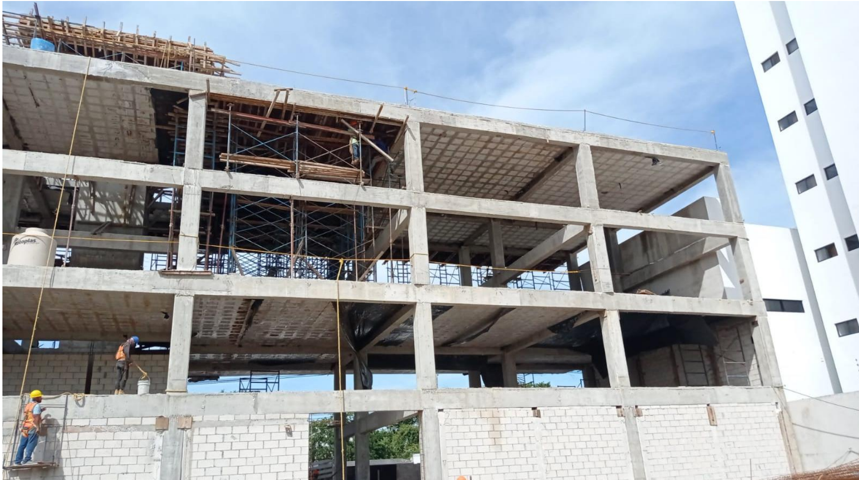
ESTRUCTURA DE CONCRETO ARMADO REALIZADA CON SISTEMA DE MARCOS RÍGIDOS COMPUESTOS POR COLUMNAS Y TRABES
