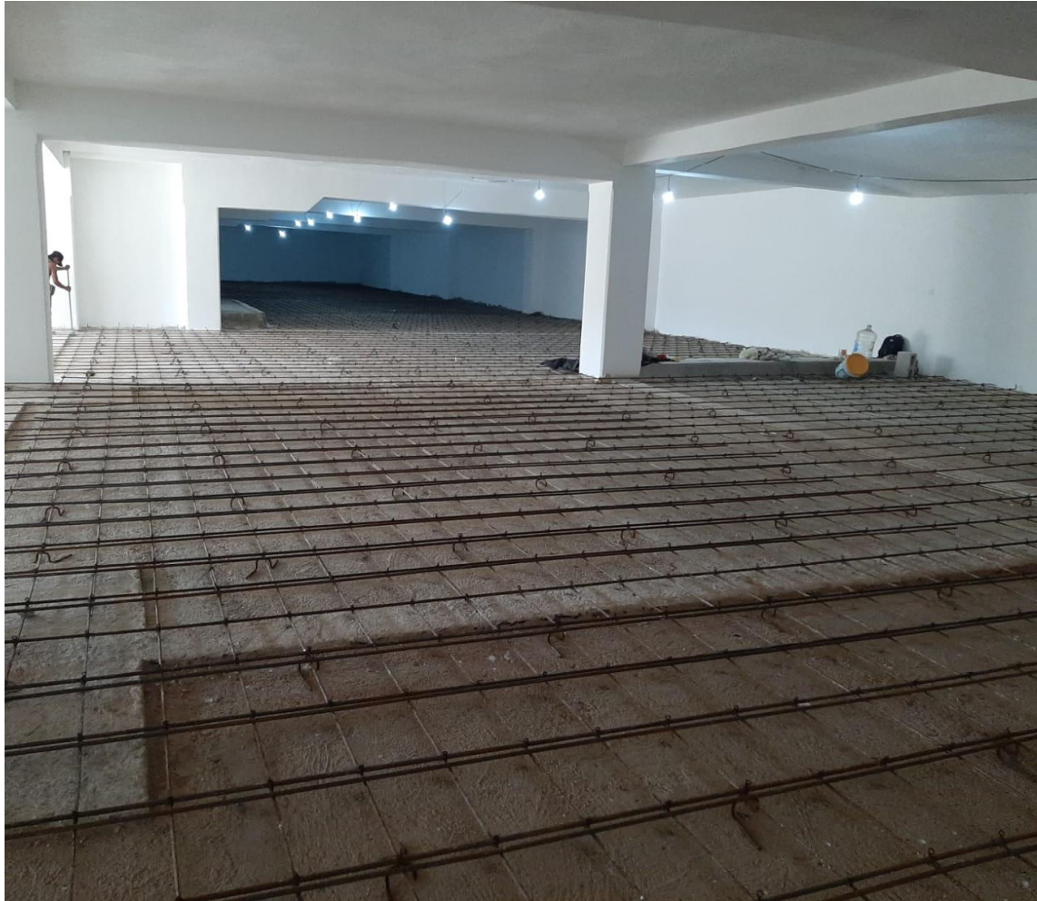
LOSA RODAMIENTO DE CONCRETO ARMADO CON UNA PARRILLA DE ACERO EN AMBOS SENTIDOS Y ESPESOR DE 15CM
