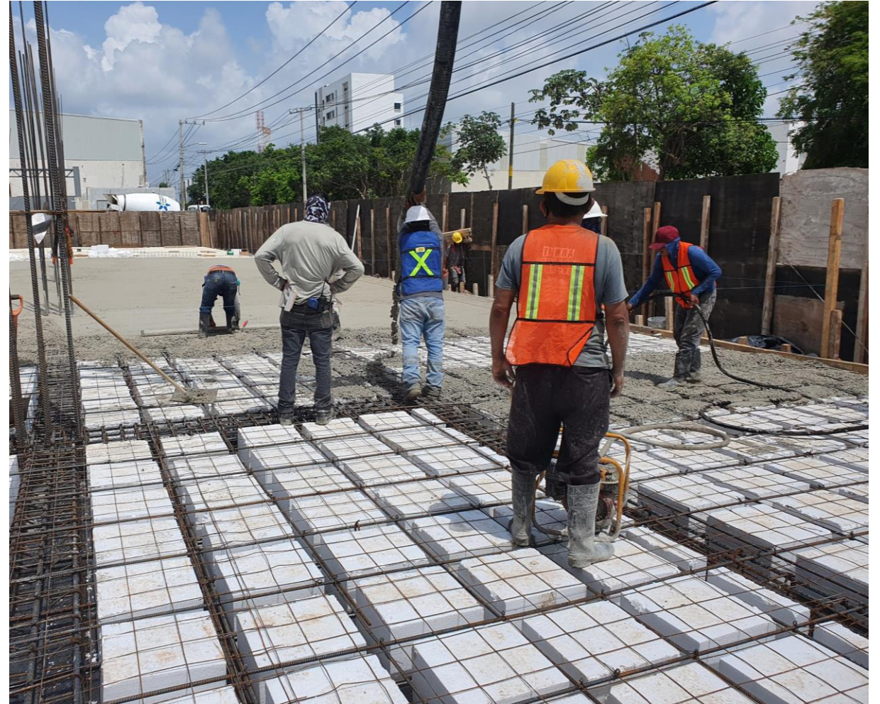
LOSAS NERVADAS DE CONCRETO ARMADO, ALIGERADAS CON CASETÓN DE POLIESTIRENO Y ESPESOR DE 35CM.
